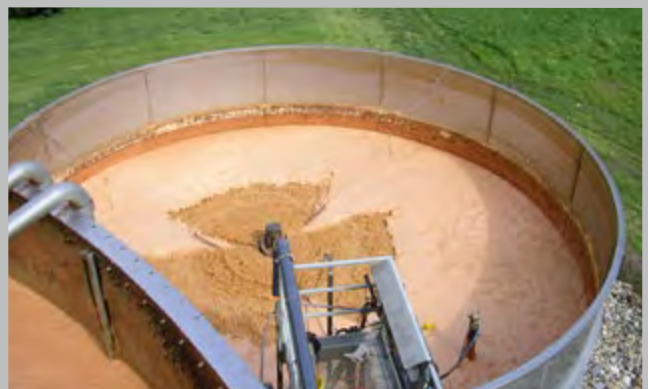
Edelstahl-Abwasserbehälter Stainless steel wastewater tank
