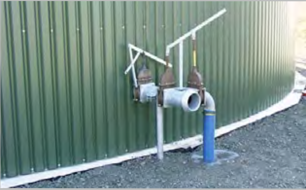
Entnahmestation am isolierten Behälter Withdrawal station at isolated tank
